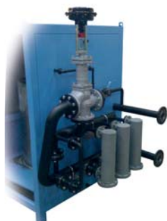
zawór 3-drożny w układzie chłodzenia
